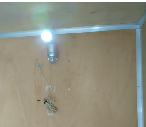
「防火備蓄倉庫内ソーラーライト」
