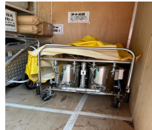
「防火備蓄倉庫内 浄水装置」
